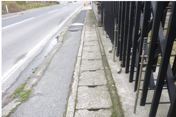
側溝の上が危険なため狭い歩道がさらに狭くなっている歩道
