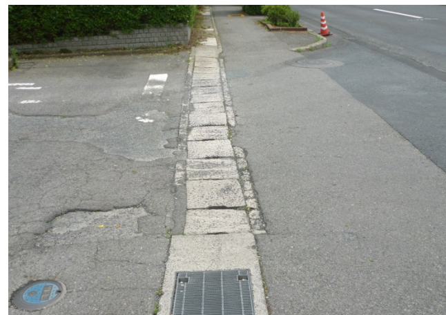
歩道の延長に大型車両の出入り口があり床版がガタガタになった歩道
