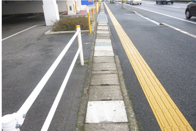
床版を掛け替えてはあるが段差がついたり危険な歩道
